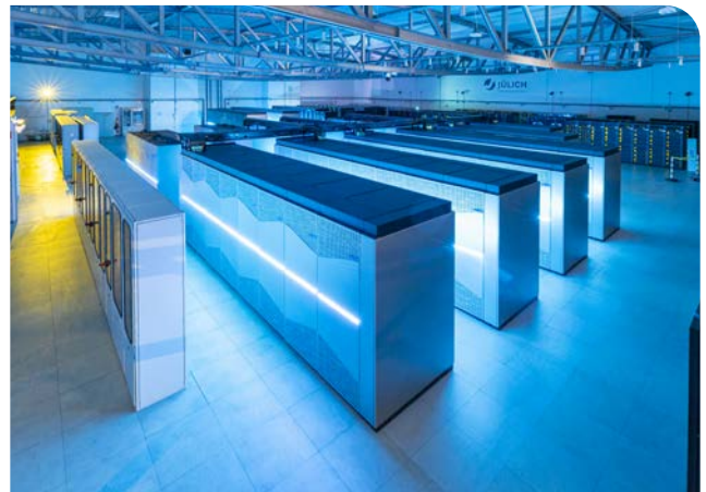
Die METIS-Forschenden haben auch Supercomputer arbeiten lassen, wie etwa JUWELS im Forschungszentrum Jülich.
