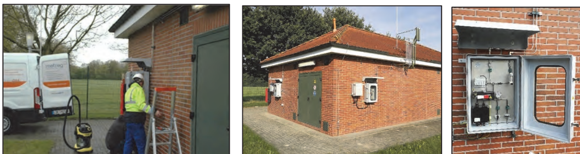
Bild 9: NKP „Schatteburg“ der Gastransport Nord GmbH
